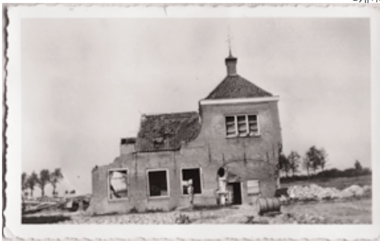
De zwaar beschadigde boerderij De Eendracht, kort na de oorlog. (Coll. mevr. J.J. de Visser)
