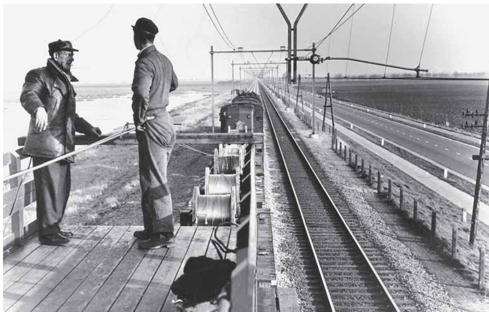
Werkzaamheden aan de bovenleiding op het spoor op de Sloedam, in de richting van Goes, februari 1957. (Zeeuwse Bibliotheek, Beeldbank Zeeland, 5939, fotoarchief PZC)
